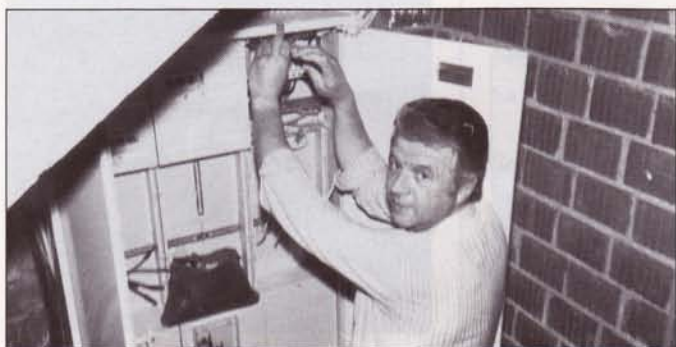
Er schafft die Kontakte im Bürgerhaus. Elektromeister und Schützenkamerad Willy Booten, seit Monaten ständig im Einsatz und verantwortlich für die gesamte Elektroinstallation des Bürgerhauses.
